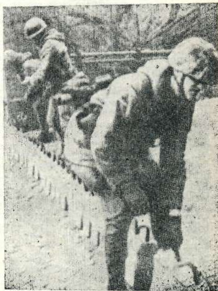
Рис. 8. Подготовка моста к разрушению кумулятивными зарядами личным составом воздушно-десантного подразделения бундесвера во время учений
